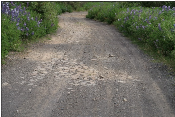
Mynd 97. Grjótpúkk í gamla Suðurlandsveginum (213-34) við Fagrahvamm, horft til suðausturs.
